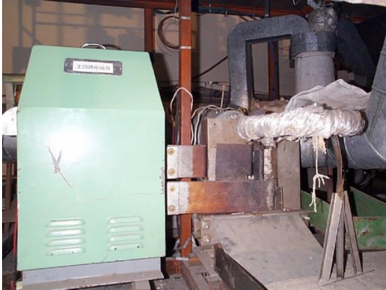
FIG. 4. EM pump for main circuit
